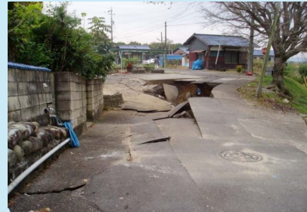
大規模陥没事故 (岐阜県御嵩町)
